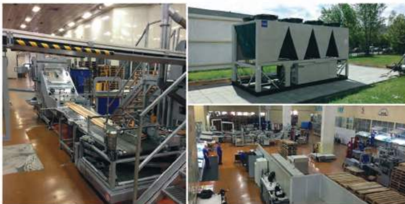
Kraj: Czechy Nazwa projektu: Svoboda Press S.R.O. Seria produktu: Chłodzony powietrzem odśrodkowy agregat wody lodowej z łożyskami magnetycznymi
