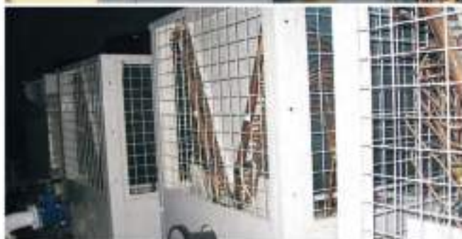
Kraj: Iran Nazwa projektu: Hotel Monjje Seria produktu: Chłodzony powietrzem modułowy agregat wody lodowej R22
